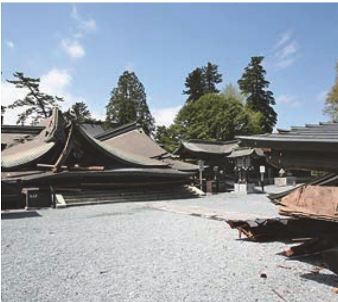
倒壊した阿蘇神社の社殿などの復旧を願います。
